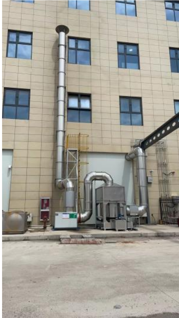
投料粉尘废气排气筒
