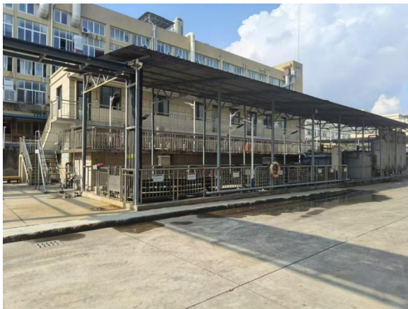
废水处理系统
