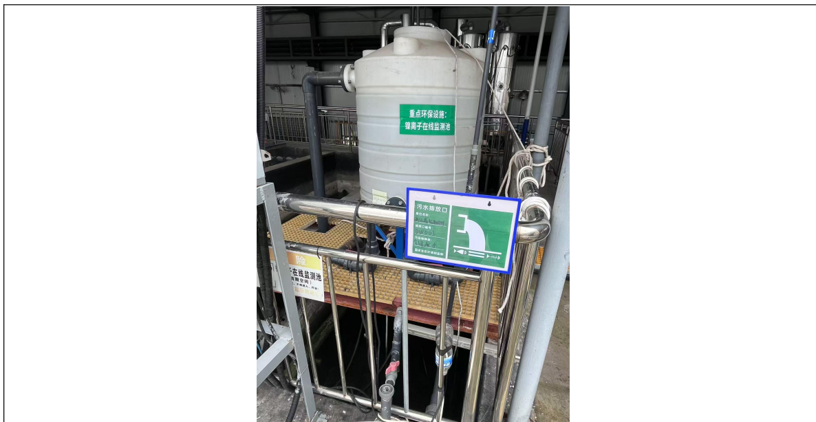
含镍废水排放口
